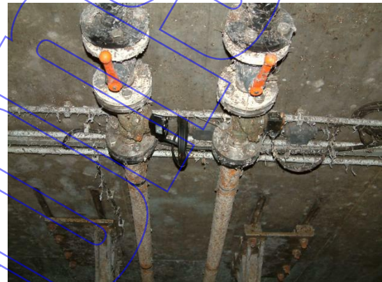
Abb. 6: Eingestaute Armaturen an der Decke
