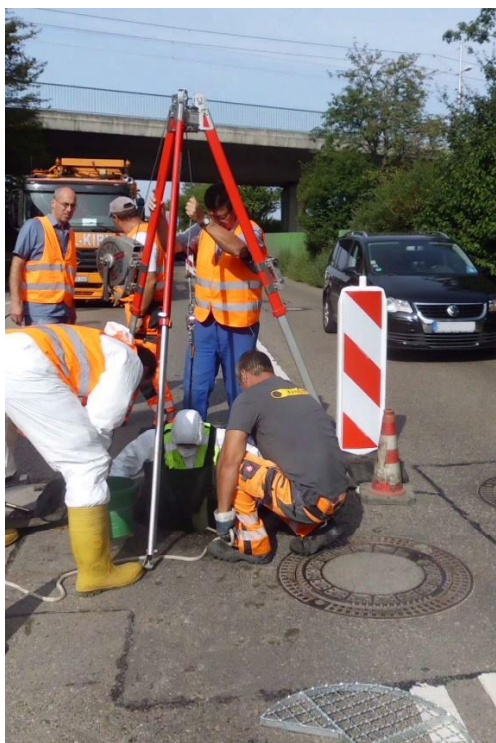
Abbildung 5: Unzumutbarer Einstieg in ein Beckenüberlaufbauwerk, welches sich unter einer stark befahrenen Straße befindet; Quelle: InfraConsult
