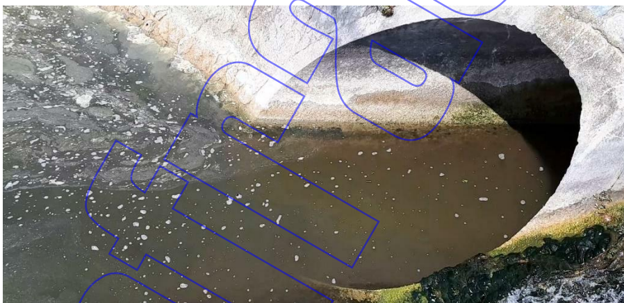
Abbildung 1: Auslass eines Regenüberlaufbeckens mit deutlich sichtbarer Auslauffahne; Quelle: InfraConsult
